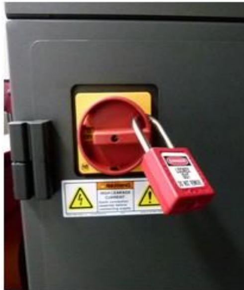
Рисунок 2: Главный выключатель в положении «Выключено» с установленным замком
