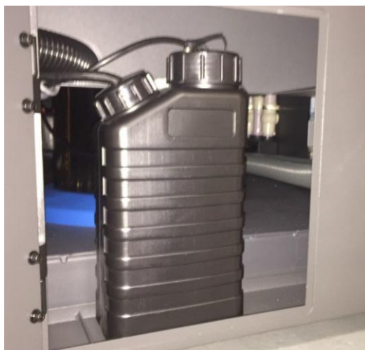
Рисунок 3-12 Контейнер для отходов краски
